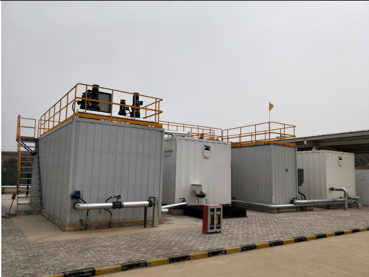
图 4-2 封闭式撬装废水处理站
