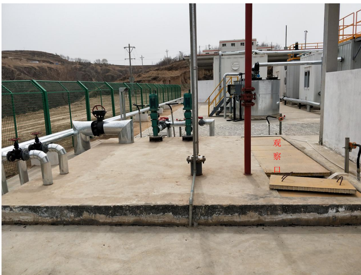
图 4-3 封闭式污泥池
