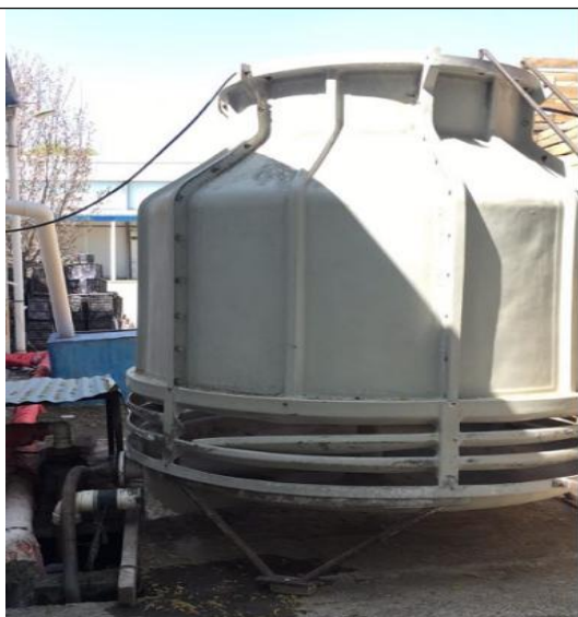
冷却塔（循环水池位于冷却塔下方）
