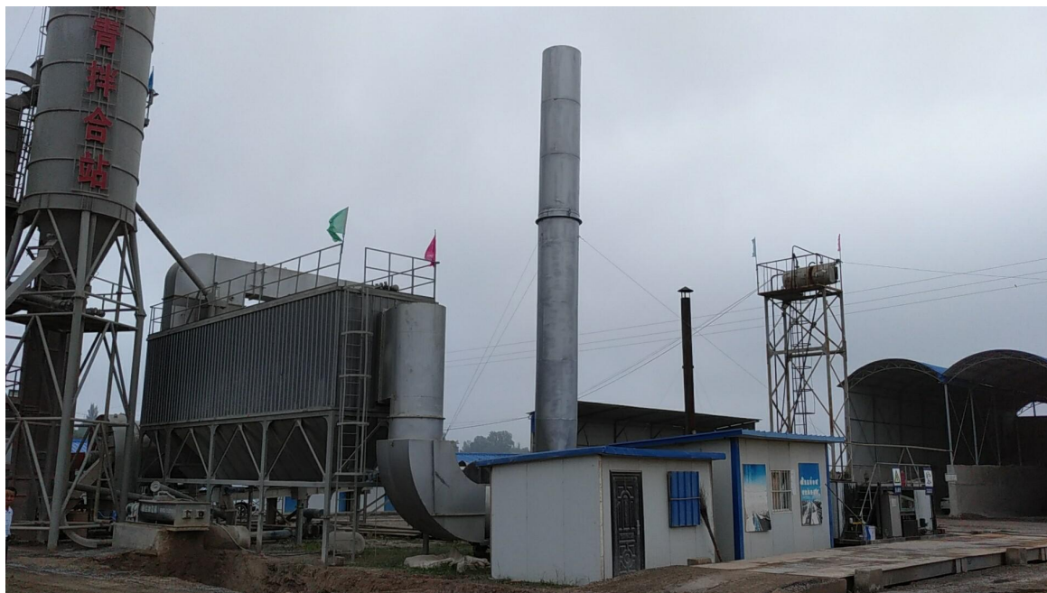
布袋除尘器+15m 排气筒
