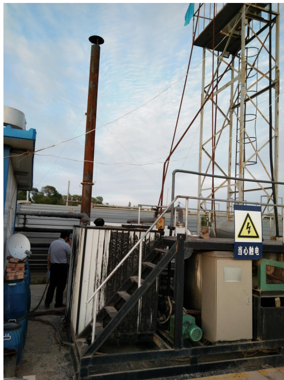
导热油炉 8m 排气筒(2#排气筒)
