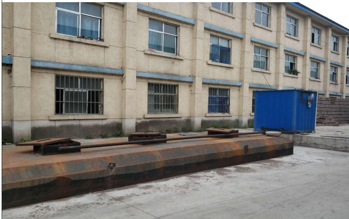
地埋式一体化污水处理设施
